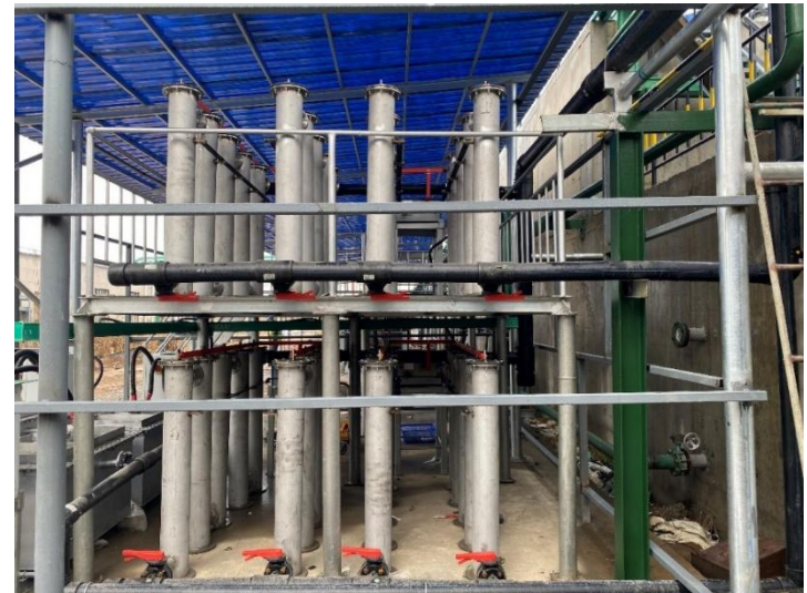
车间现场装置运行图示
