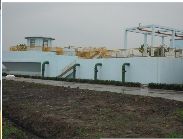
臭氧-活性炭滤池
