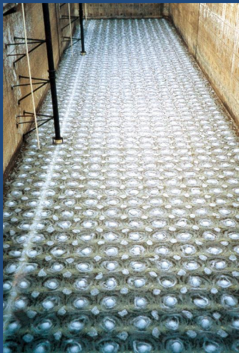
曝气器运行现场
