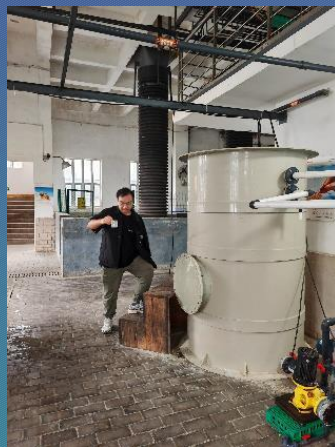
现场中试设备
