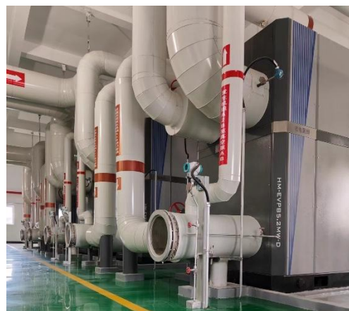
二楼换热机组
