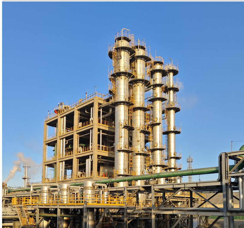
某兰炭企业酚氨回收装置
