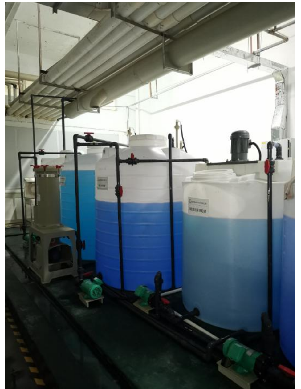
药剂调配罐及废液中转罐
