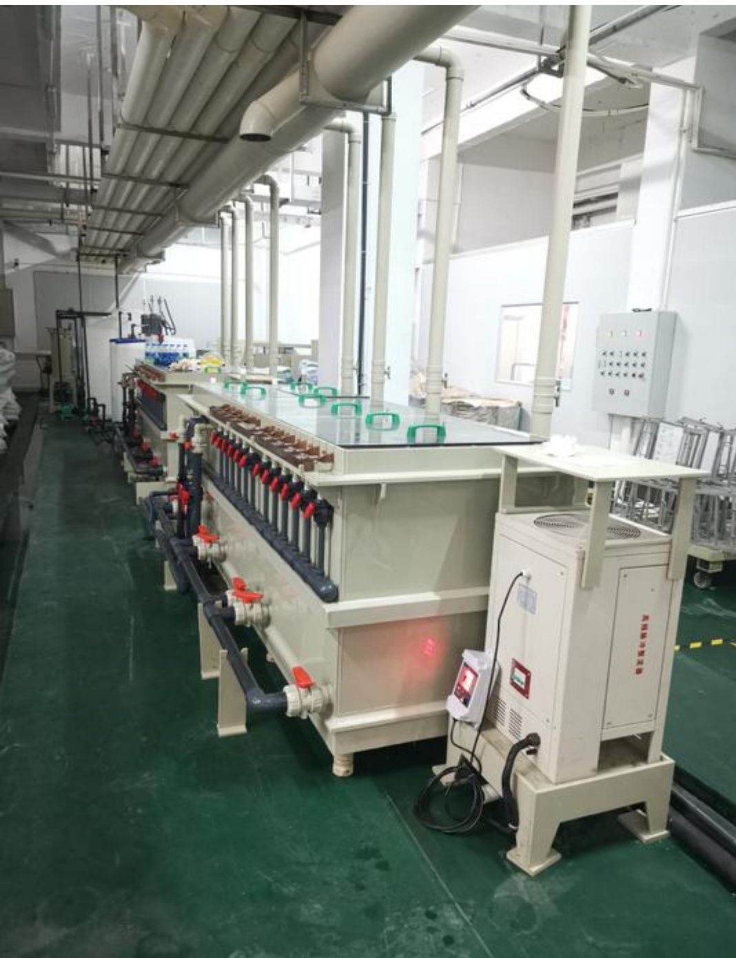
广东某线路板企业微蚀废液过硫酸钠再生铜回收设备实景图
