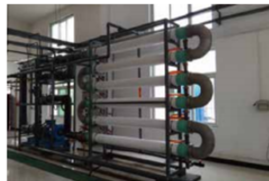
垃圾渗透液 污泥处理
