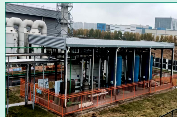
深度除氟达标排放现场
