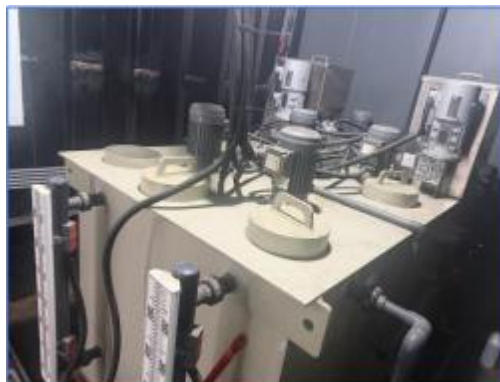
混凝剂投加系统
